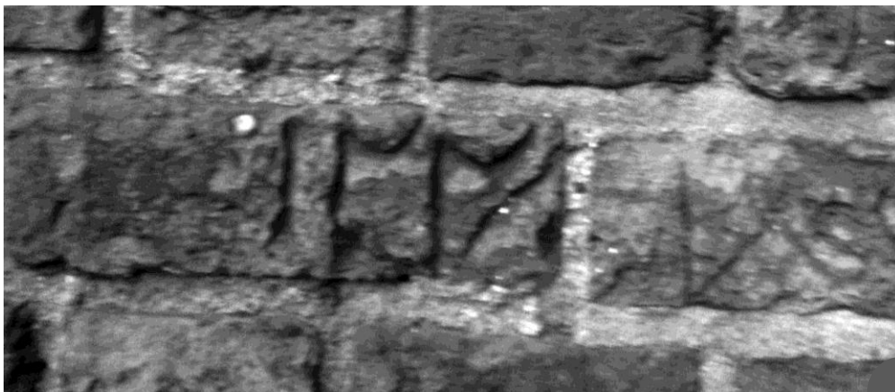
1557 – prawdopodobna data pożaru miasta i katastrofy budowlanej fary
